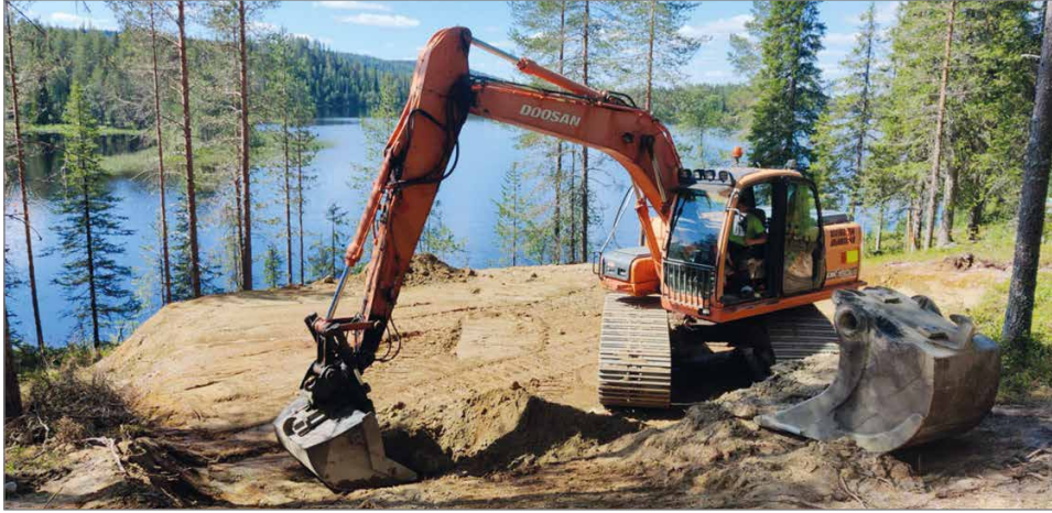
Syötteen maansiirto Oy:n välillä on usein maisemat kohdillaan, sillä varsinkin mökkipohjia on tehty runsaasti Syötteen komeisiin maisemiin.
