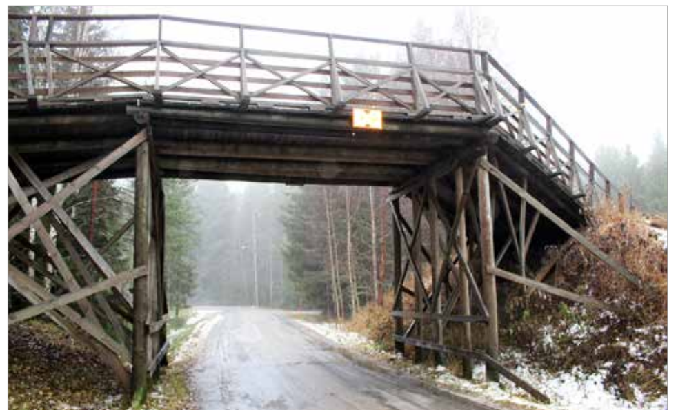
Illinsaaren hiihtosillat ovat toistaiseksi käyttökielossa korjaustöiden vuoksi. Kuvan silta (eteläinen) on valmistunut 1990-luvun puolivälissä. Toinen silta on kymmenisen vuotta vanhempi.
