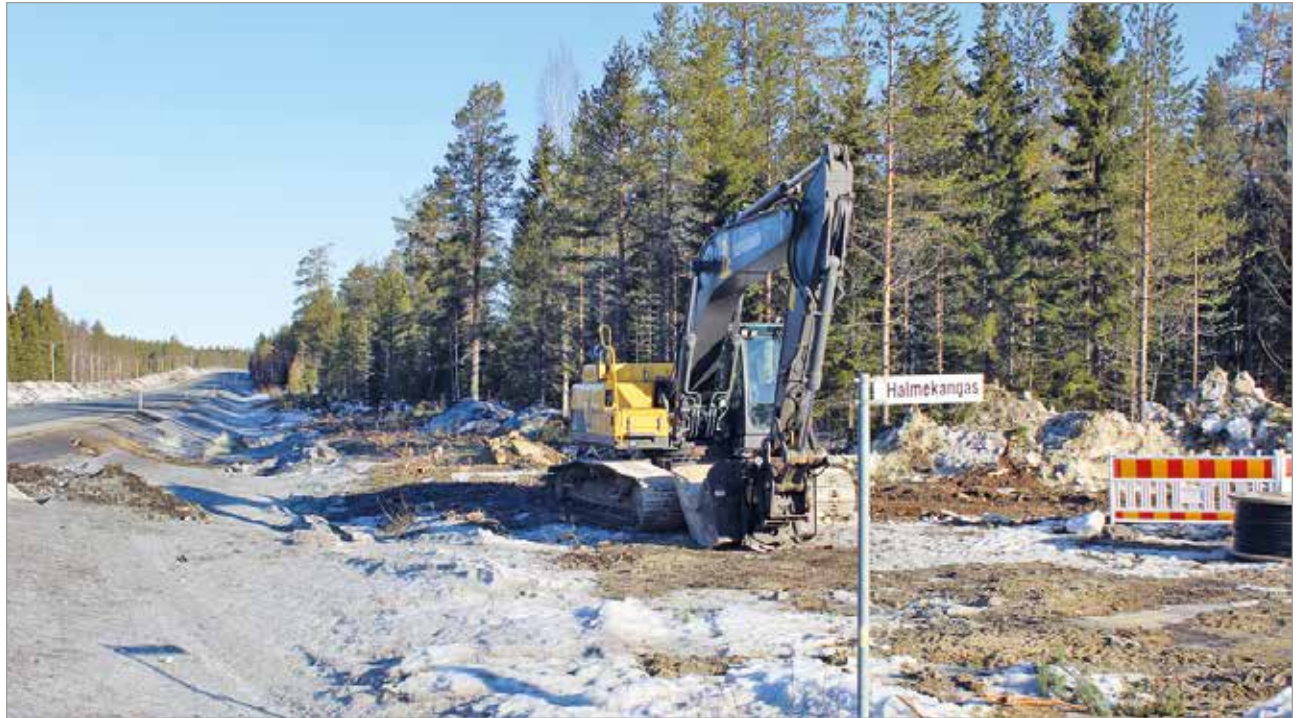
Ohituskaistojen rakentaminen Kuivaniemi – Simo välille on alkanut. Käynnissä on puunpoisto ja rakennustöiden valmistelu.
