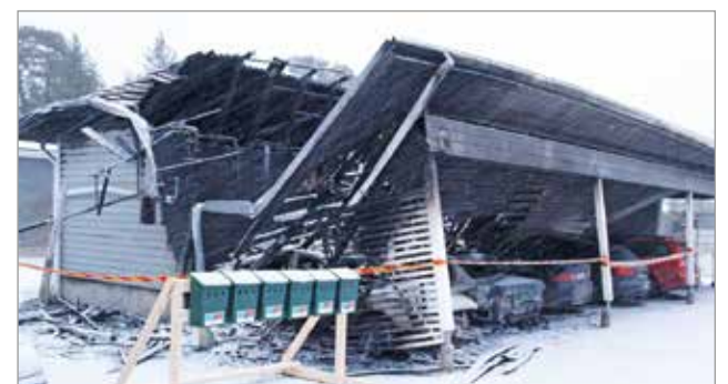
Rantakestilän tiellä tapahtunutta autokatospaloa tutkitaan tuhotyönä. Palossa tuhoutui täysin kaksi autoa ja useita muita vaurioitui.
