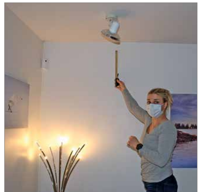
Poikkeusoloissakin voidaan tehdä opastuskäyntejä, kunhan huolehditaan turvaohjeiden noudattamisesta. Olohuoneesta löytyi sopiva paikka, johon Mari-Annika Hamarin suosittelemana sijoitettiin toimittajan hankkiman ilmalämpöpumpun sisäyksikkö.
