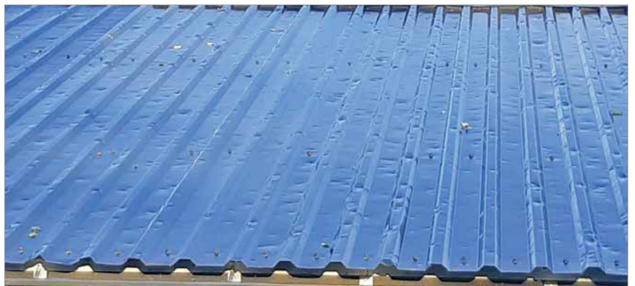
Myös peltikatot kärsivät suuria vaurioita. (Kuva Jouni Ahola)
