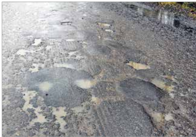
Ojakyläntien alkupää on päällystetty, mutta heikossa kunnossa.
