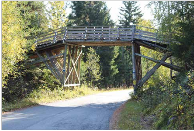
Illinsaaren kuntoreittien vanhempi silta on rakennettu 1980-luvun alussa. Sillan kansi on irrotettu useita kertoja paikaltaan talopakettirekkojen tieltä.
