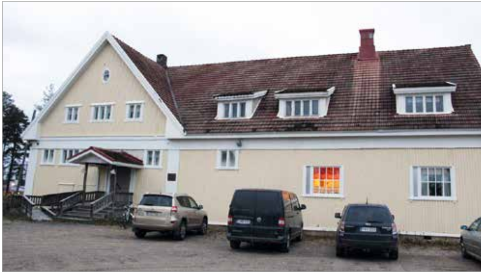
Iin Urheilijoiden toimitalon katto on tullut käyttöikänsä päähän. Nykyinen tiilikatto korvataan tulevina keväänä huopakaton.
