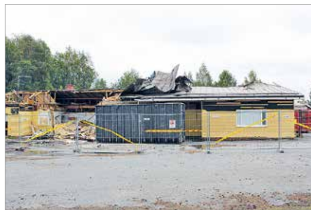
Iin Sähkötien varressa puretaan vuonna 1963 valmistunutta Iin Energian entistä toimitaloa. Tontille rakennettaneen rivitalo.
