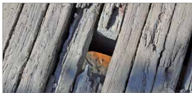
Monin paikoin sillan läpi näkee alas Liesojaan. Siltaremontti saatiin alulle yhdennältoista hetkellä.
