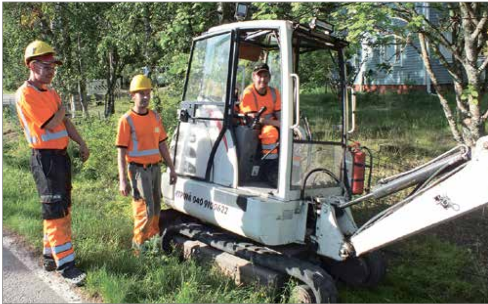
Aki Kipinä koneen ohjaimissa, sekä Veli-Pekka Ålander ja Iikka Sairanen viimeistelevät maankaivurakkaa Alarannalla, ennen siirtymistään Koniin ja Hiivalaan.
