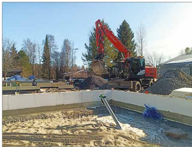
Janne Riepulan maansiirtokalustoon kuuluu myös pyörillä liikkuva kaivinkone, jolla hoituvat näppärästi muun muassa vesi- ja viemärintikaivuut sekä rakennusten pohjatyöt.
