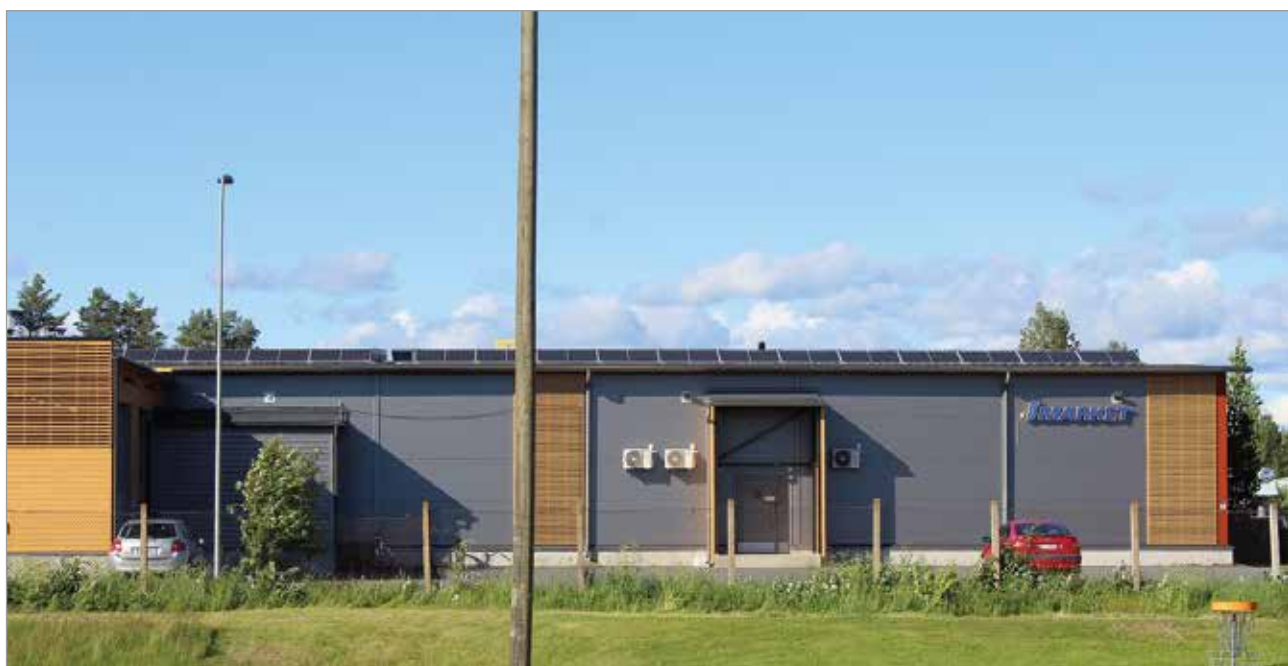
S-Market Iin katolle ilmestyneet aurinkopaneelit tuottavat sähköä yrityksen omaan käyttöön.
